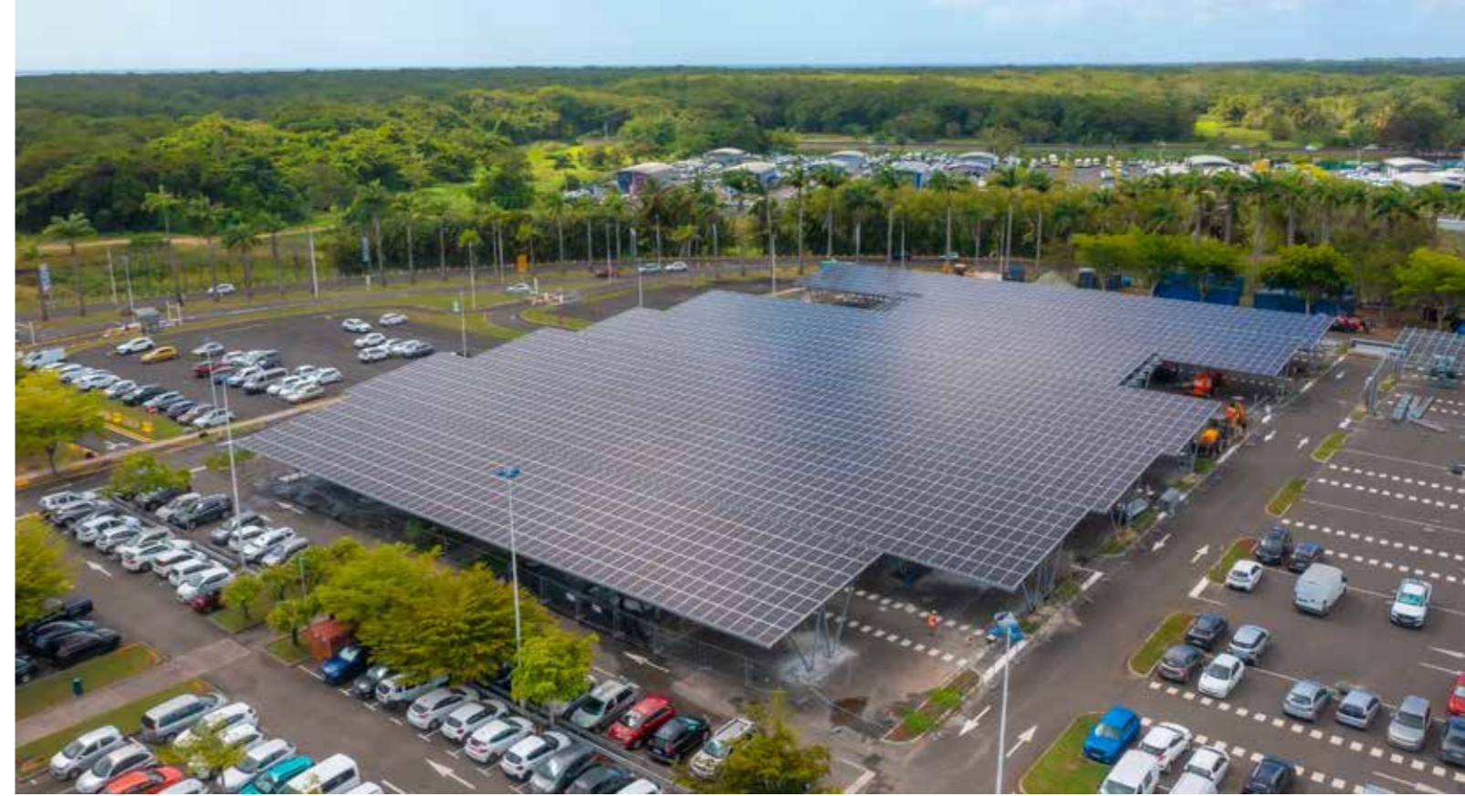
Afin d'augmenter la production d'électricité verte sur le site de l'aéroport, des panneaux photovoltaïques ont été installés au P2 (photo) ainsi que sur la gare de fret et la gare régionale.
